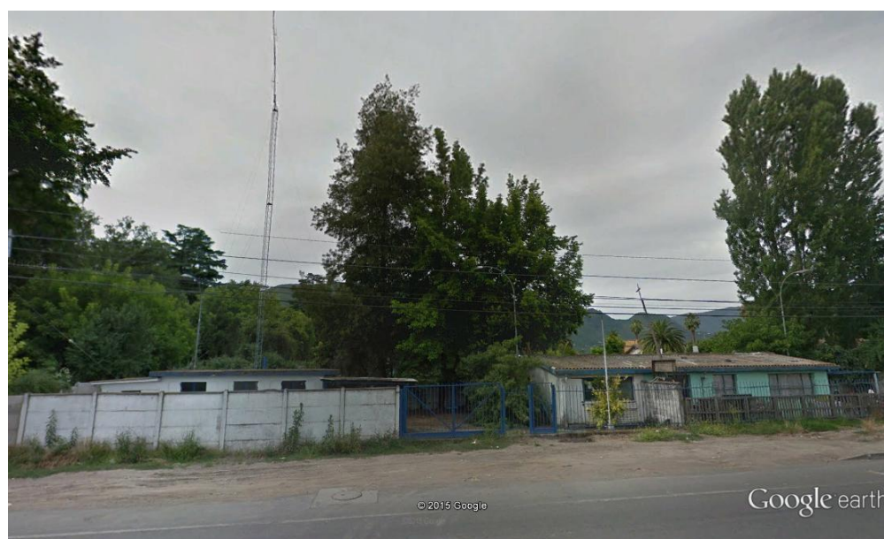
Figura 7. Planta Elevadora de Aguas Servidas Libertad.
