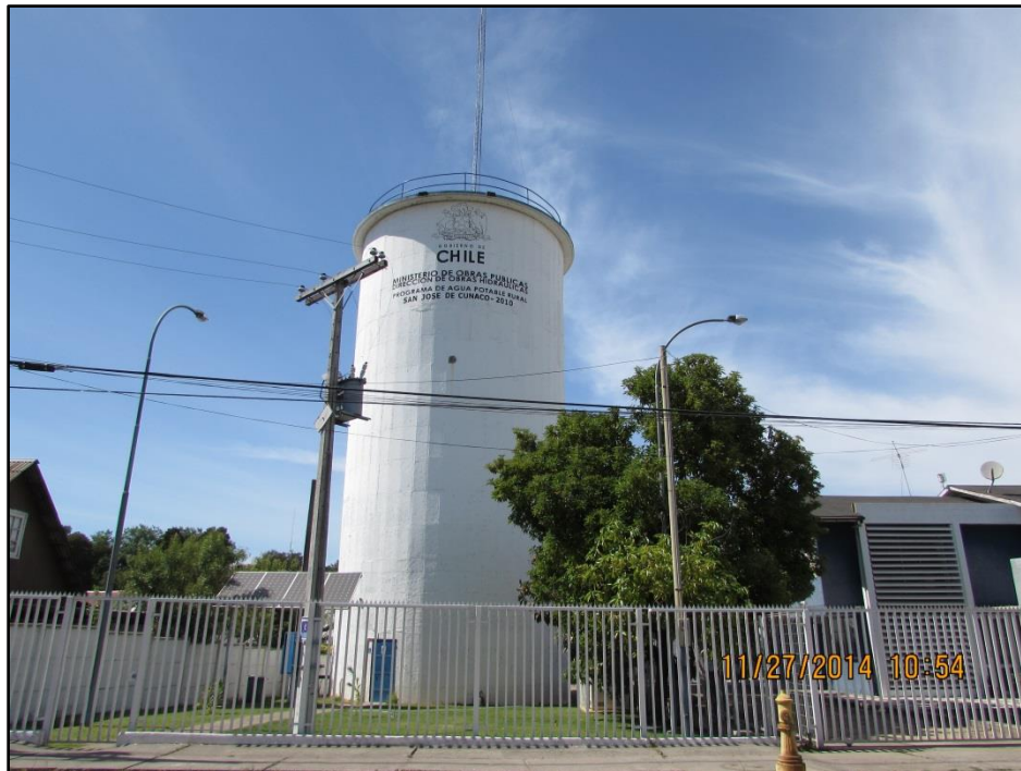
Figura 4. Recinto De Sondaje (18 l/s), Estanque (200 m 3 ) y Administración Aguas Cunaco Ltda.
